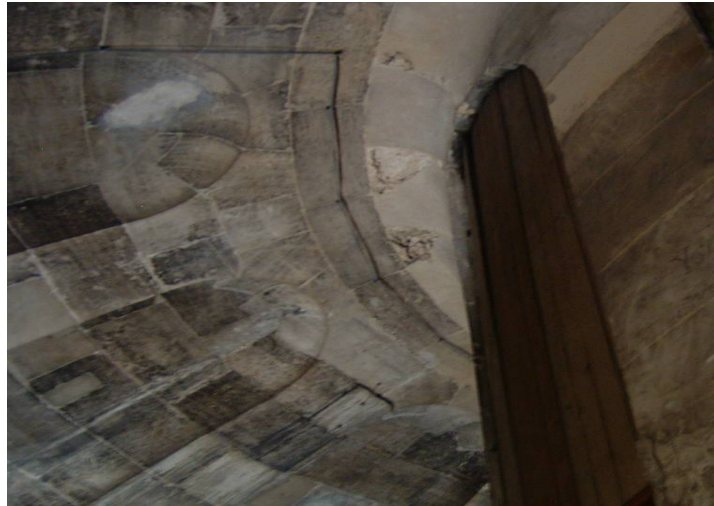
Figura 2.5.5 – Foto delle lesioni nella zona di contatto tra la lanterna e la cupola esterna 40 .
