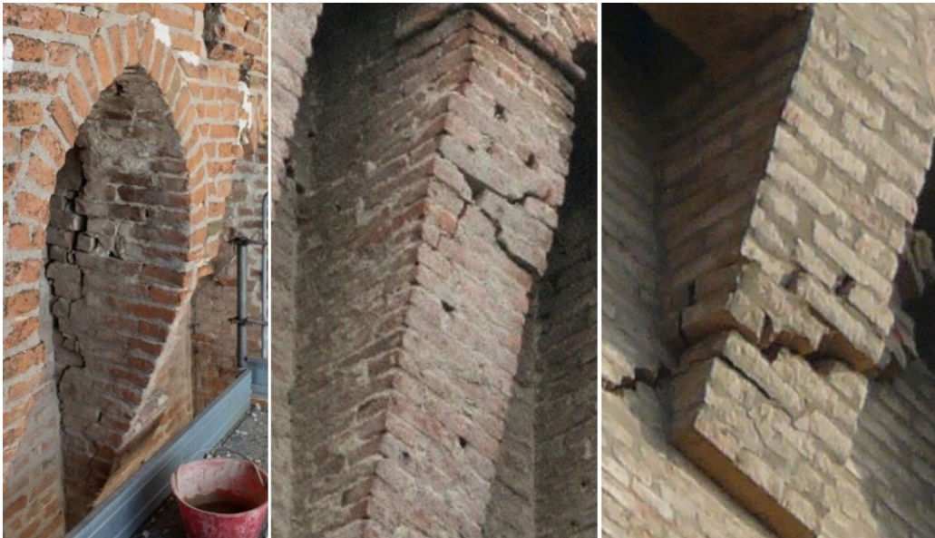
Figura 35 Lesioni ai beccatelli di Rocca di San Felice sul Panaro, del Mastio del Castello di Galeazza Pepoli e del Castello dei Ronchi.
