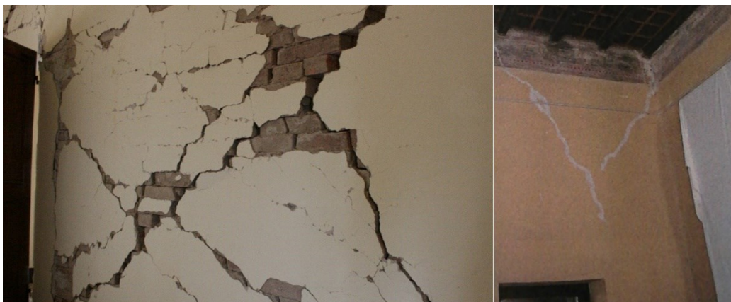
Figura 20 Le lesioni a taglio nel piano delle aperture interne sono un buon indice di funzionamento della scatola muraria. In foto si riportano due dei tanti esempi ( da sinistra): Castello di Galeazza Pepoli e Castello dei Bentivoglio.
