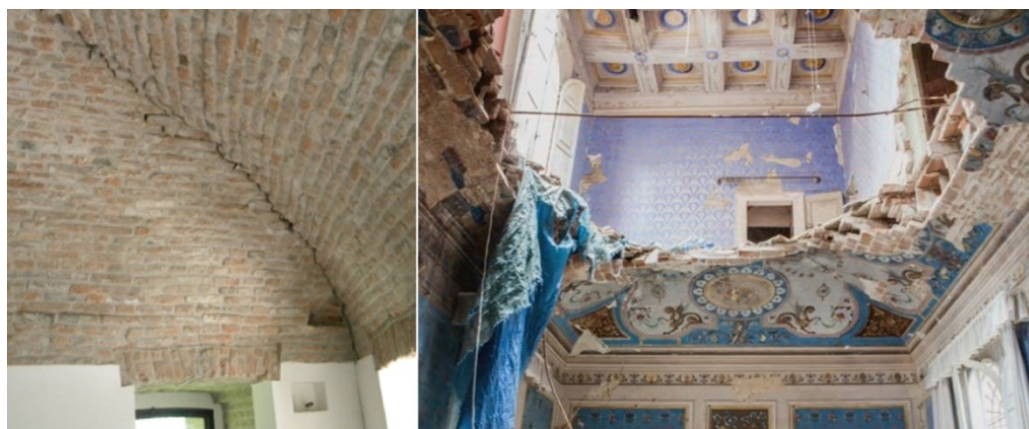
Figura 26 Deformazioni per rottura nel piano a taglio della volta: a sinistra la volta della Rocca di stellata di Bondeno gravata da un carico concentrato al centro; a sinistra il crollo di una delle volte ribassate e molto sottili del Castello di Galeazza Pepoli.
