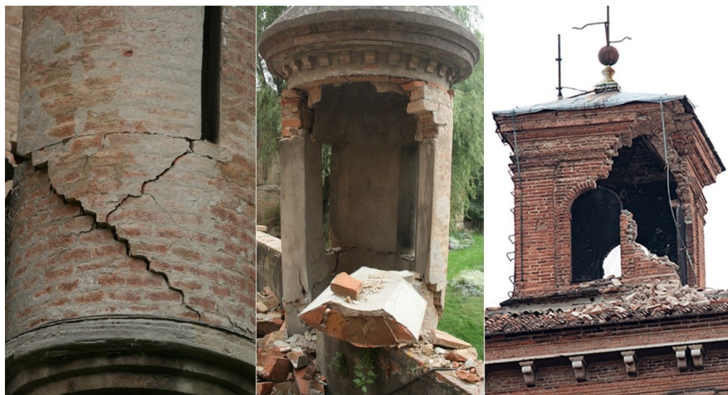
Figura 31 A sinistra due foto delle esili garitte neogotiche lesionate del Castello di Galeazza Pepoli a Crevalcore. A destra la lanterna della Torre dei Leoni danneggiata, Castello estense di Ferrara.
