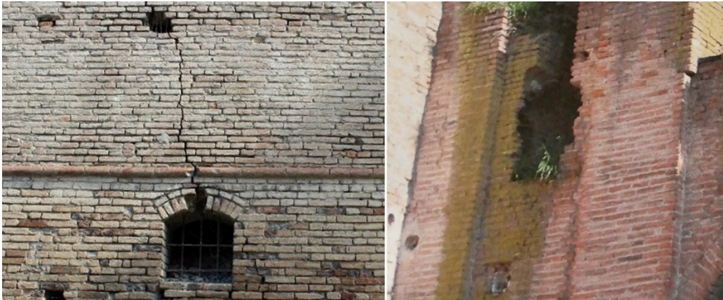
Figura 6 Lesioni da taglio nelle mura d cinta verificatesi in corrispondenza di aperture: a sinistra Rocca dei Gonzaga, Novellara; a destra Rocca, Pieve di Cento.
