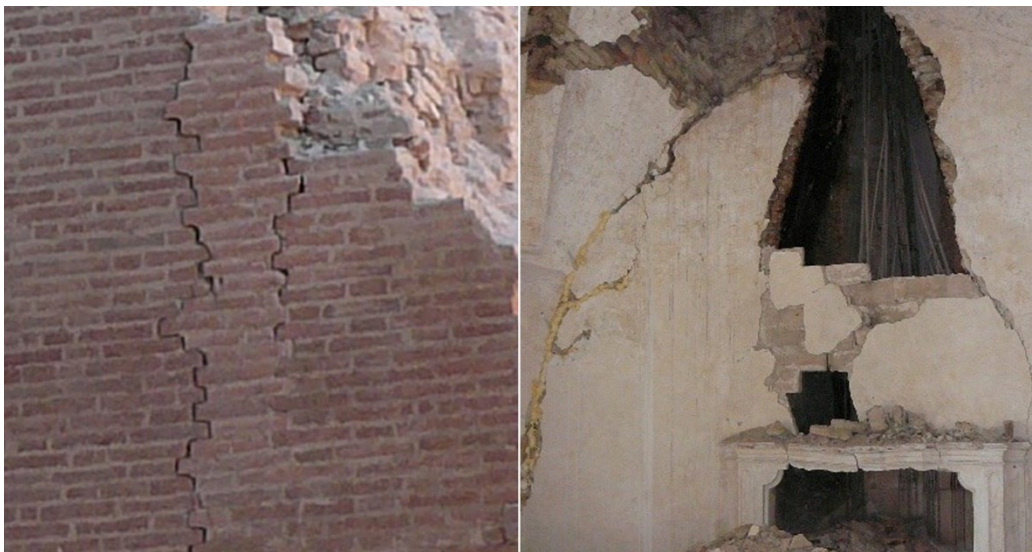
Figura 3 A sinistra dettaglio della torre del Castello Lambertini a Poggio Renatico. Si noti come la muratura risulti lesionata in corrispondenza di una tubatura nascosta all'interno della muratura. A destra, nel mastio della Rocca di San Felice, altra vulnerabilità tipica legata alla presenza di canne fumarie. In entrambi i casi si tratta di discontinuità all'interno della muratura che la rendono meno resistente.
