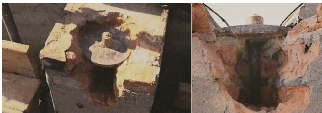
Figura 9 Fotografie tratte dalla Relazione di Variante del Progetto esecutivo per della Rocca estense di San Martino in Rio (2018). Durante i lavori sono emersi gli interventi alle merlature del Torrizzo eseguiti dopo il sisma del 1996.
