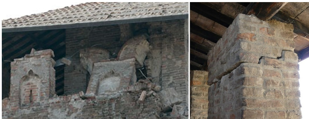
Figura 19 Ribaltamento di merli con copertura: a sinistra il merlo mal collegato con la copertura della Rocca di Finale Emilia, a destra un merlo con copertura spingente della Rocca di San Felice sul Panaro.
