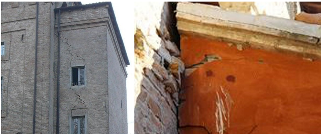
Figura 29 Lesioni a taglio del corpo annesso al Castello dei Ronchi a Crevalcore; Casamatta danneggiata addossata al muro di cinta soggetto a ribaltamento fuori dal piano (Rocca estense di San Felice).
