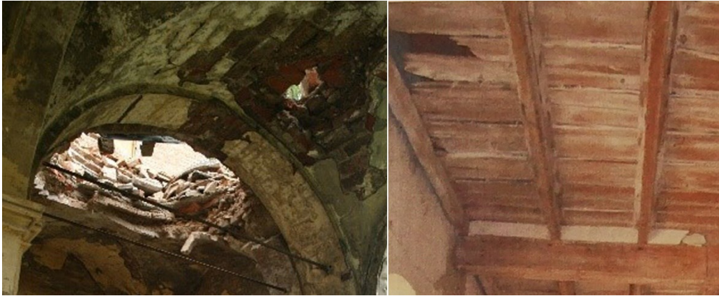
Figura 24 A sinistra crolli localizzati nelle volte del Castello di Galeazza Pepoli; a destra danno a un impalcato ligneo del Castello estense a San Martino in Rio.
