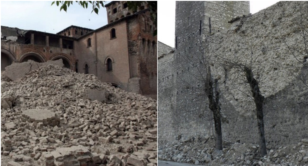
Figura 1 A sinistra il mastio crollato della Rocca di Finale Emilia; a destra le mura di Norcia. Pur essendosi verificati anche in Emilia, i fenomeni di disgregazioni sono risultati molto comuni in Centro Italia per via delle caratteristiche materico-costruttive di quest’area.
