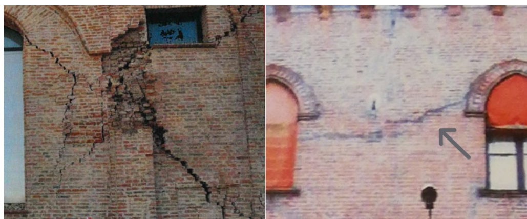
Figura 18 Tipiche lesioni a taglio dei maschi murari: a sinistra lesione a X con espulsione di materiale, Castello dei Pico della Mirandola; a destra lesione che collega due aperture, Castello Lambertini, Poggio Renatico
