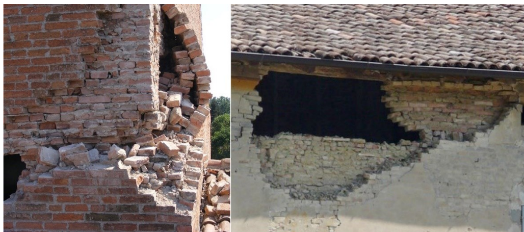
Figura 2 Lo spessore delle murature in Emilia in generale, e dei suoi fortilizi in particolare, è dato da fogli di muratura accostanti, ma spesso non ben collegati tra loro. Tal tecnica costruttiva ha dato luogo a episodi di delaminazione, ad esempio il mastio della Rocca di San Felice sul Panaro (a sinistra) e il Castello Galeazza Pepoli (a destra).
