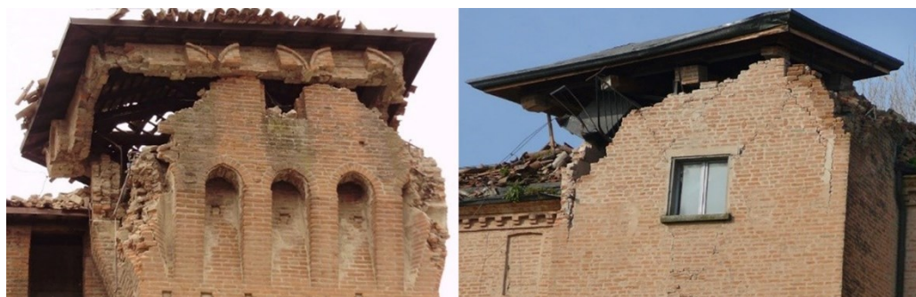
Figura 12 Scorrimento della copertura favorito da cordoli rigidi: a sinistra Rocca estense a San Felice sul Panaro; a destra Castello dei Ronchi, Crevalcore.
