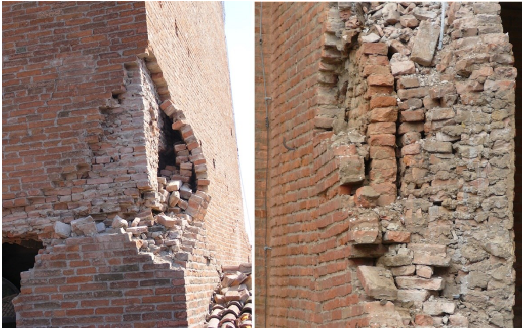
Figura 3 I crolli del 2012 hanno fatto emergere la struttura muraria di queste fabbriche, con spessori murari costituiti da più fogli spesso non ben collegati trasversalmente tra loro. In foto due dettagli dei danni subiti dalla Rocca di San Felice sul Panaro, Modena.
