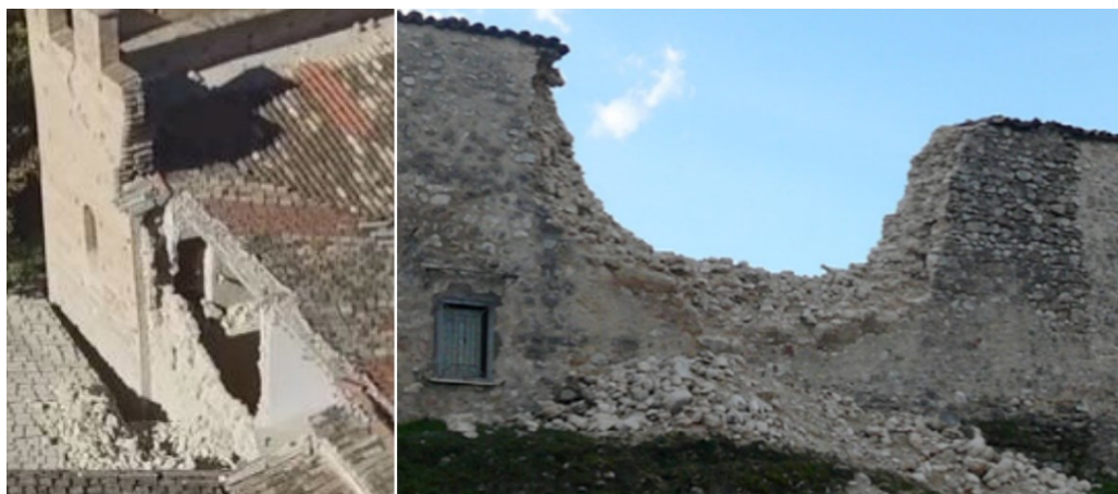
Figura 5 Due esempi di flessione orizzontale del muro di cinta: a sinistra Castello Pallotta, Caldarola, nel maceratese; a destra Mura di Norcia (Perugia).
