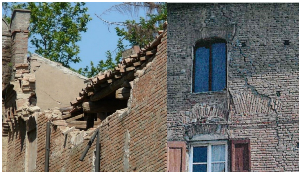
Figura 15 Due esempi di flessione orizzontale fuori dal piano. A sinistra Castello di Galeazza Pepoli a Crevalcore; a destra Castello dei Pico a Mirandola.
