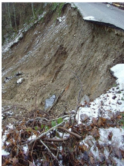
Figura 52. La frana che ha avuto luogo a Cappadocia nei pressi dell'Aquila il 1° dicembre 2010.
