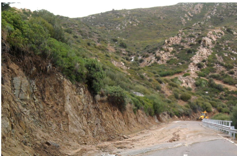
Figura 41. Le condizioni del manto stradale a Villasimius a seguito del nubifragio del 10 ottobre 2010.
