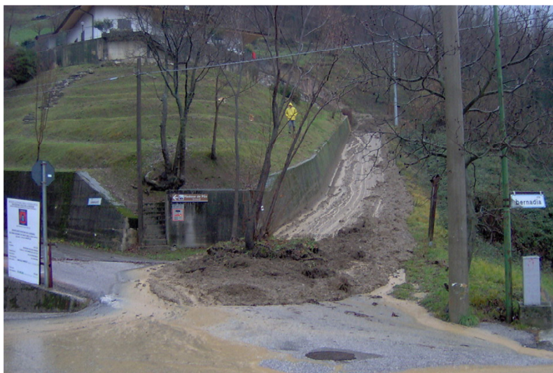
Figura 10. La frana che ha avuto luogo a Tarcento (Udine).
