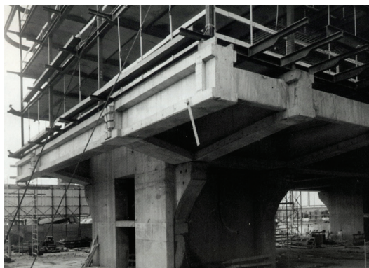
Sezione dell'edificio e pianta del piano tipo degli uffici; vista della struttura / Vertical Section and offices floor plan; Structure's view
