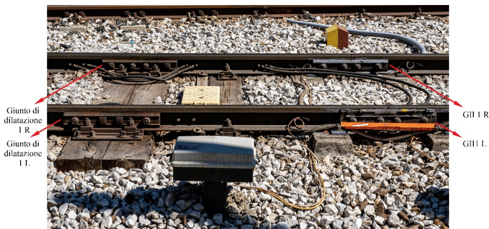
Figura 4-9 Giunto di dilatazione in adiacenza ai GII monitorati dai sensori 1R e 1L
