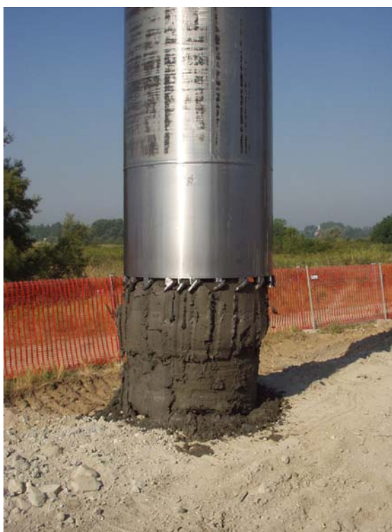
FIG. 7-20 - JET GROUTING – CAMPO PROVA A TERRA DI LIDO – FASI DI ESTRAZIONE DELLA COLONNA JGT8, SPEZZONE SUPERIORE TRA -6.5 E -11.5 M S.L.M.M.
