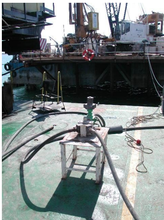
a) Raccordo dei due tubi di mandata della miscela, provenienti dalle 2 pompe
