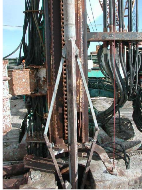
Strumentazione DOC.I.L.E. montata sulla sonda parzialmente aperta
