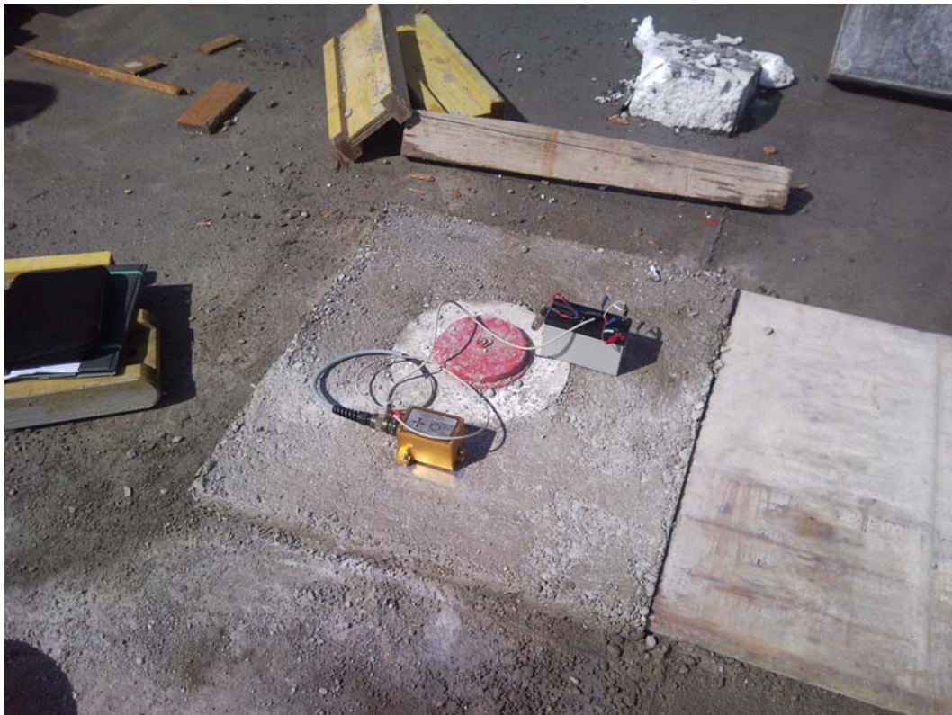
INCLINOMETRO BIASSIALE INSTALLATO DURANTE LE FASI DI PRECARICA PER LA MISURA DELLE ROTAZIONI DEI CASSONI
