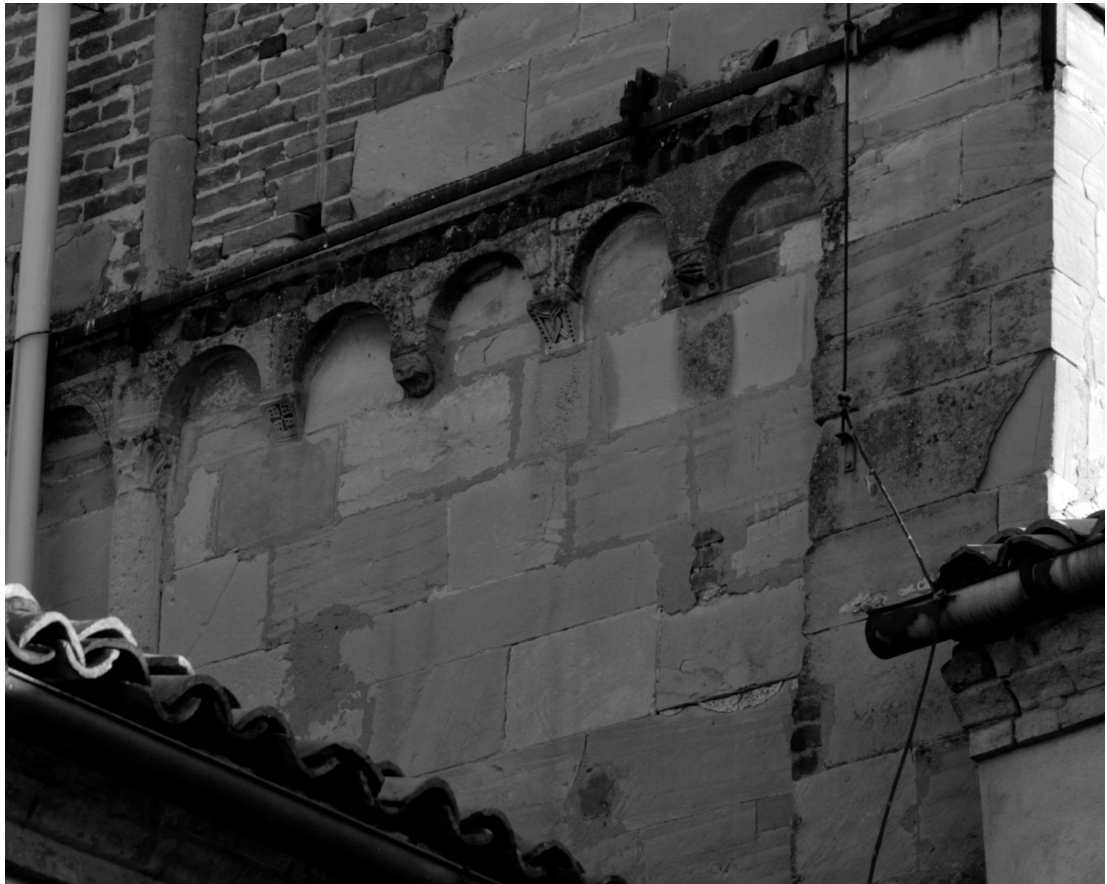
In alto: Particolare degli archetti e peducci del fianco ovest; in basso: fianchi sud ed est (a sinistra), fianco est, danneggiato nel crollo del 1907 (a destra)
