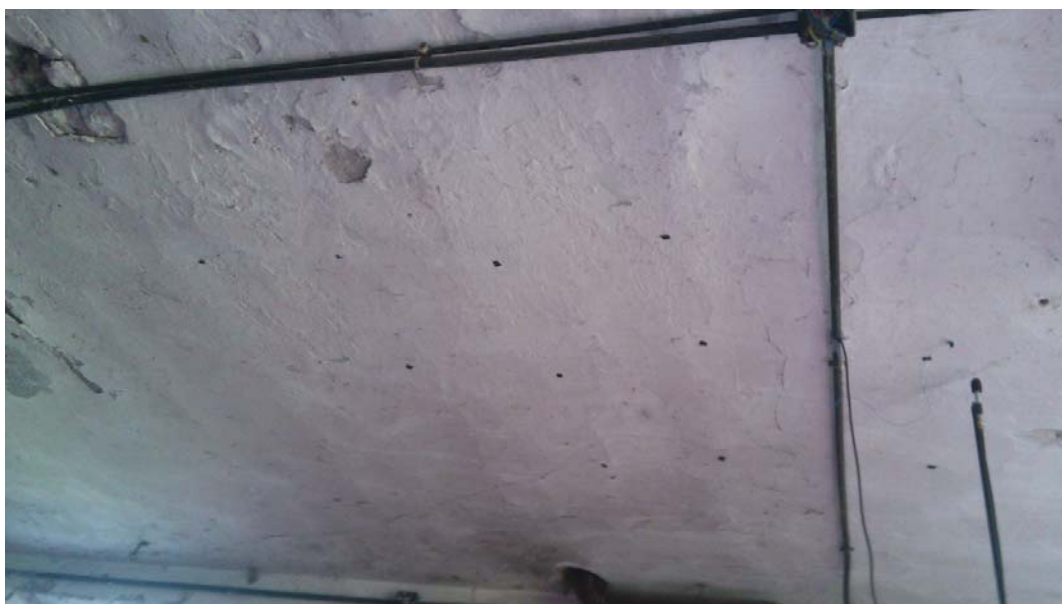
fig. 5.9 - Griglia di misura all'intradosso del fabbricato esaminato
