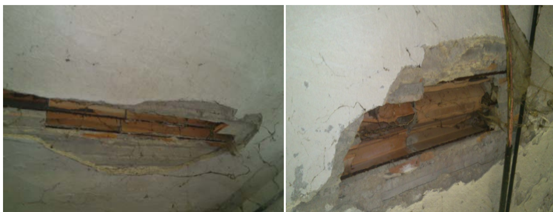
fig. - 5.8 - Struttura danneggiata esaminata
