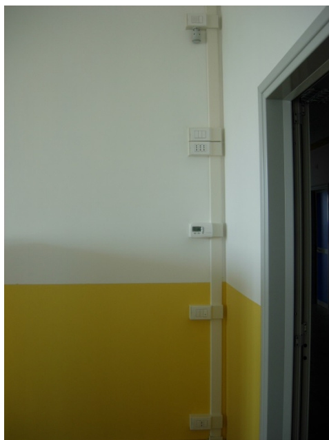
fig. 4.12 - canaline porta-cavi nell'ambiente emittente
