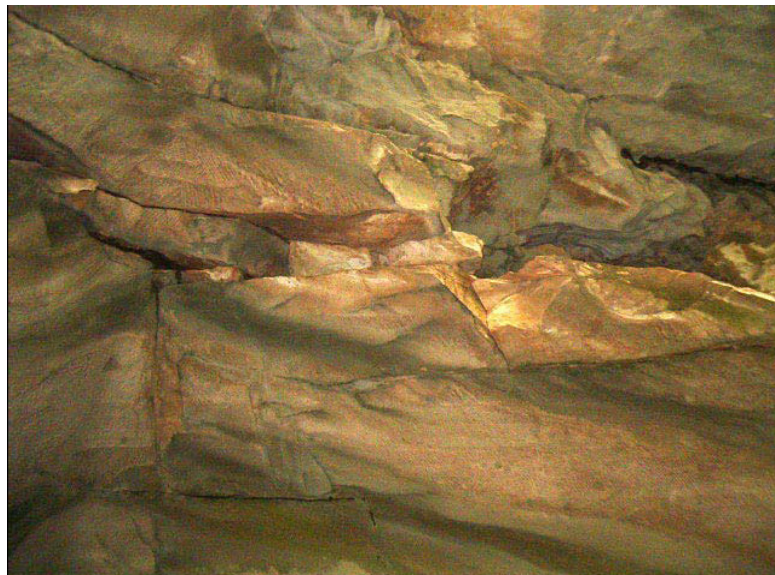
Figura 3.5. Ammasso roccioso fratturato presso l'imbocco basso, in cui l'interazione fra le famiglie di discontinuità (N-S, E-W, superfici di stratificazione) determina la formazione di più elementi tabulari e
