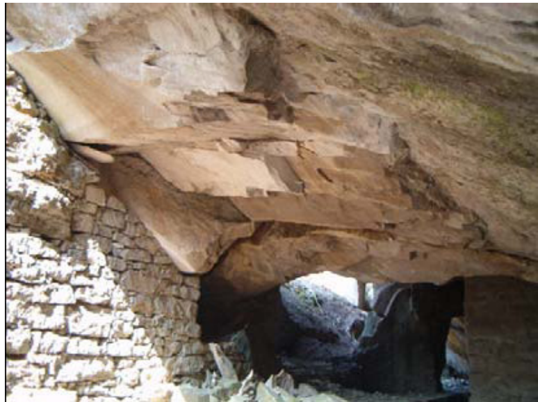
Figura 3.6. Ammasso roccioso fratturato presso la soletta dell'imbocco principale, sede di rilievo geomeccanico; tale zona è stata sede di distacco di più elementi rocciosi, come dimostrato dall'accumulo sul pavimento.
