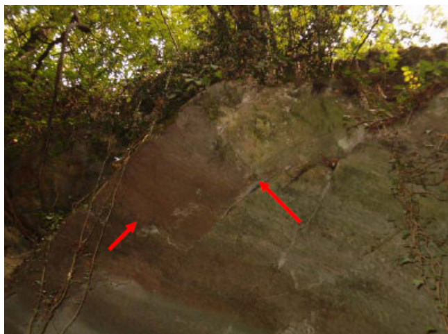
Figura 3.13. Blocco svincolato in soletta ancora parzialmente saldato alla stessa.
