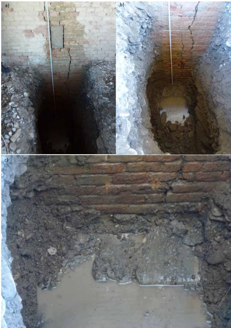
Figura 107 a), b) lesione verticale fino al piano di fondazione; c) cordolo di fondazione in pietra.
