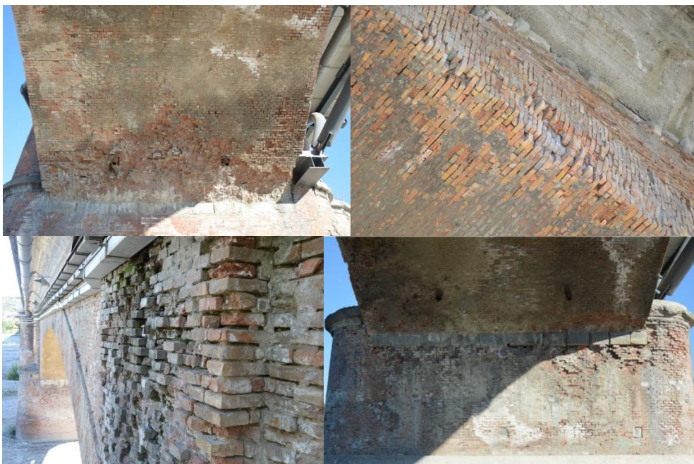
Figura 236 Esfoliazione, polverizzazione dei giunti di malta ed efflorescenze riscontrate nella muratura con il rilievo
