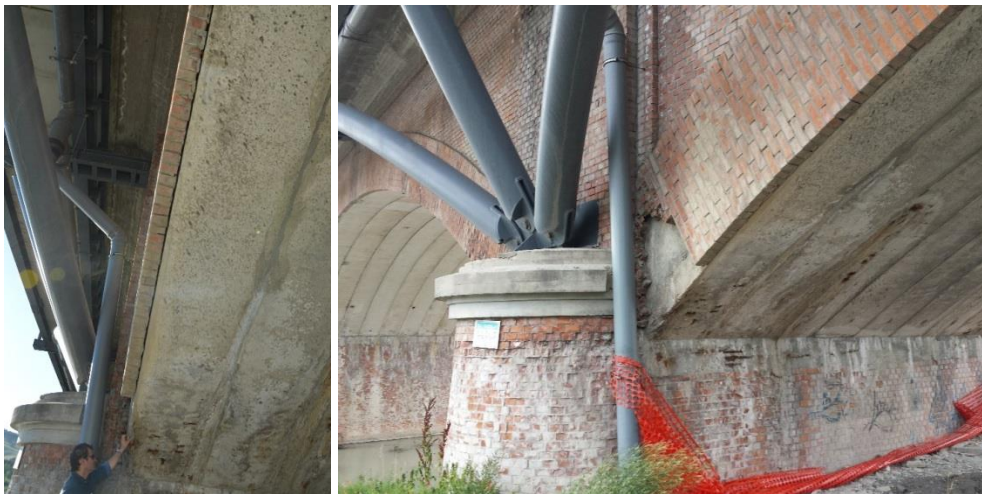
Figura 239 Armilla: porzione di ponte di nuova costruzione. Evidenza delle rotture in corrispondenza dell'imposta
