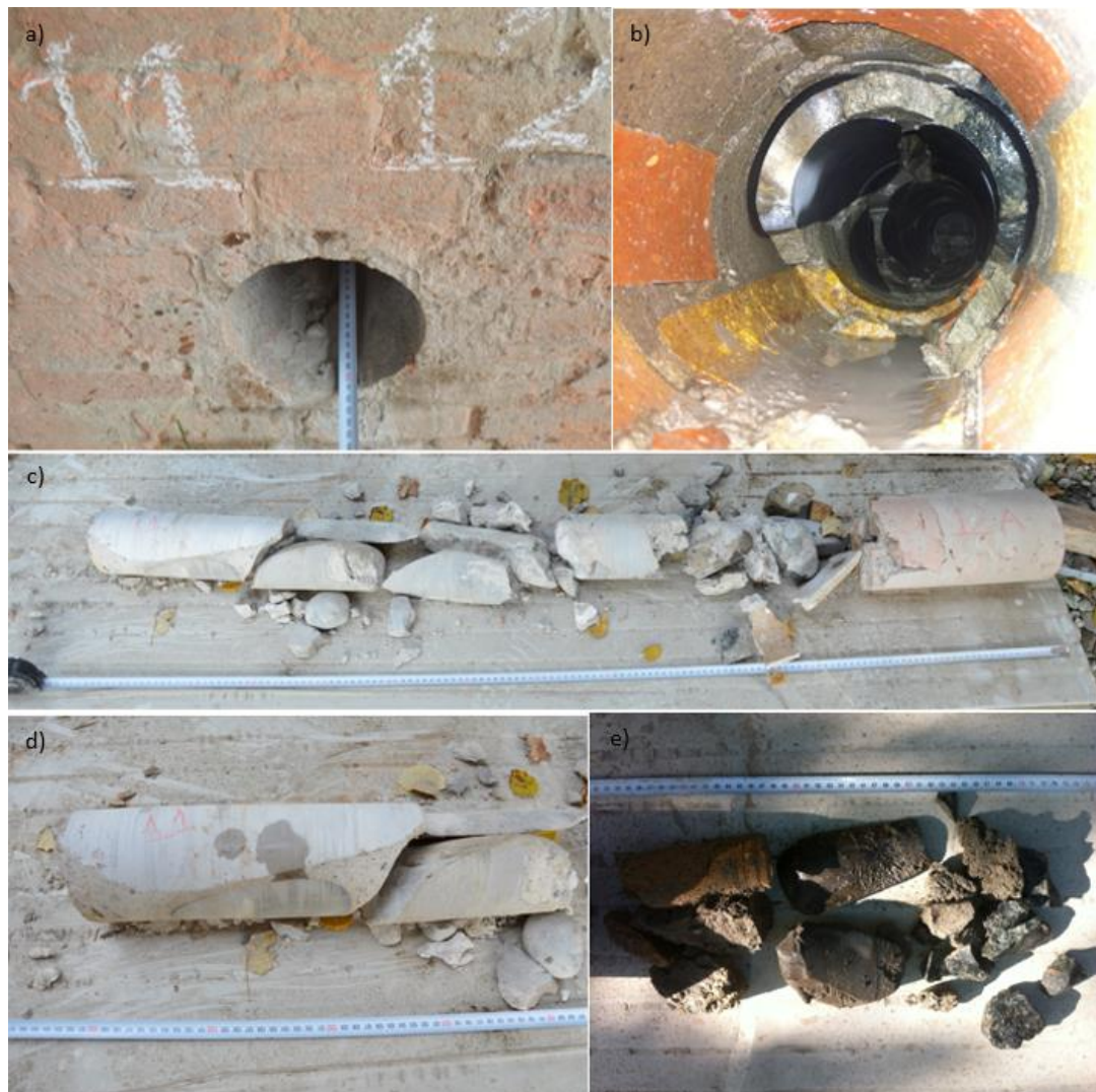
Figura 79 a) foro N°11; b) dettaglio del foro N°11; c) carota N°11; d), e) dettaglio del riempimento della pila.
