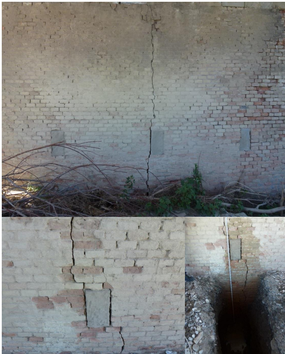
Figura 255 Fessura verticale in prossimità della pila N°6
