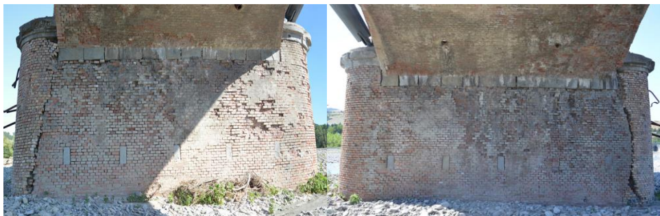
Figura 256 Pila N°10: fessura passante lato valle.
