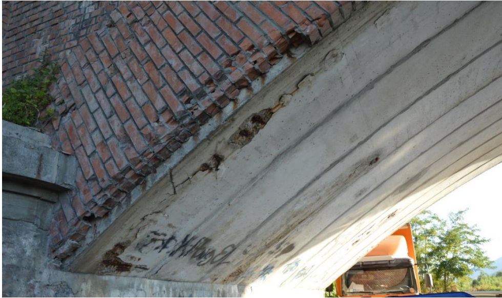
Figura 243 Armilla danneggiata: imposta lato valle arcata N°20.
