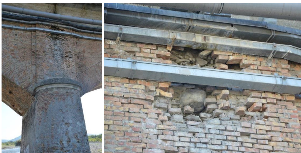
Figura 237 Distacco dei mattoni dovuto al ciclo di gelo e disgelo.
