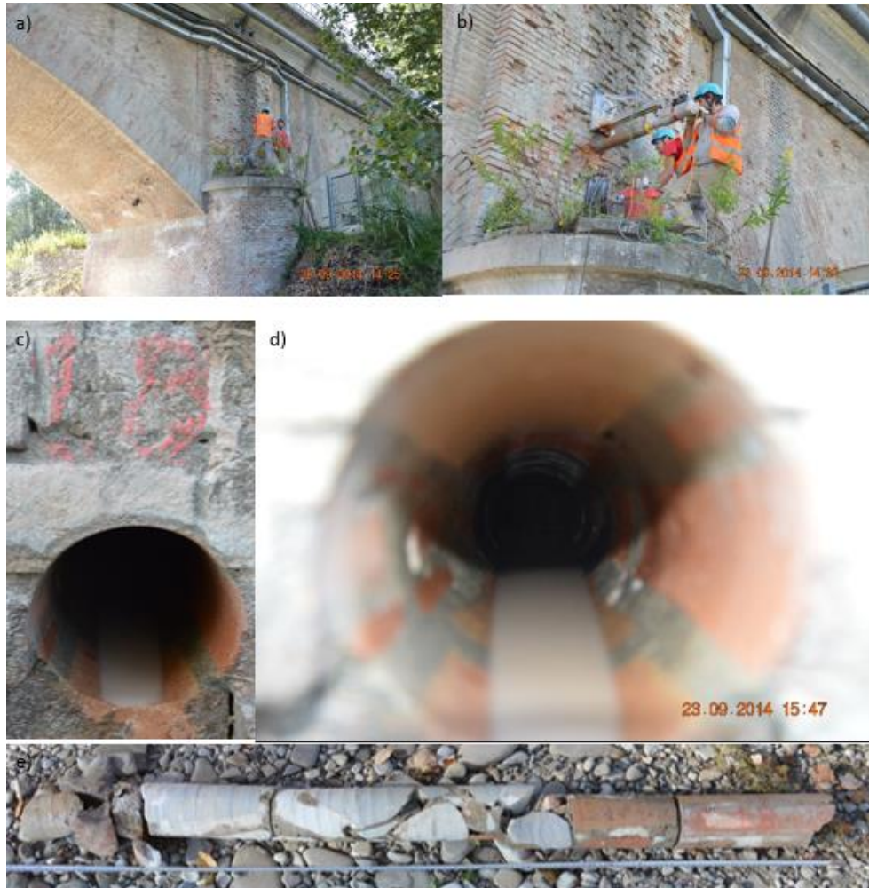
Figura 98 a), b) posizione ed esecuzione del foro N°18; c), d) foro e dettaglio foro N°18; e) carota N°18.
