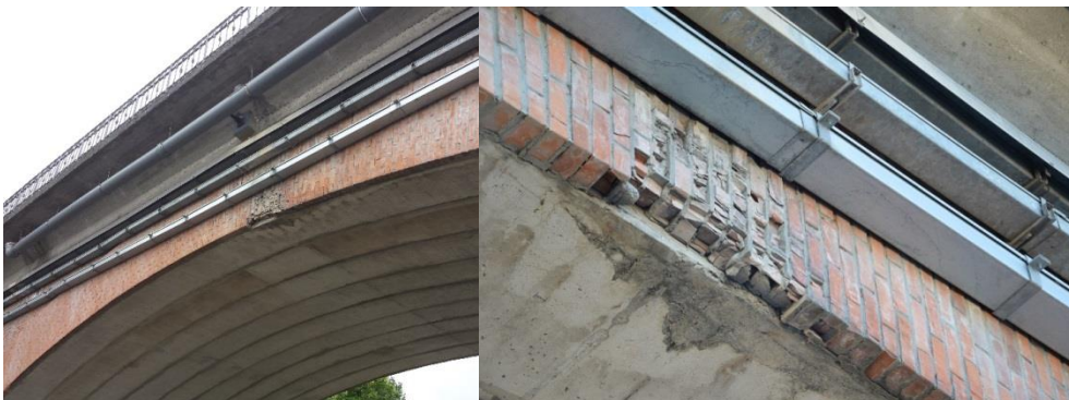
Figura 242 Armilla danneggiata: chiave lato valle arcata N°20.
