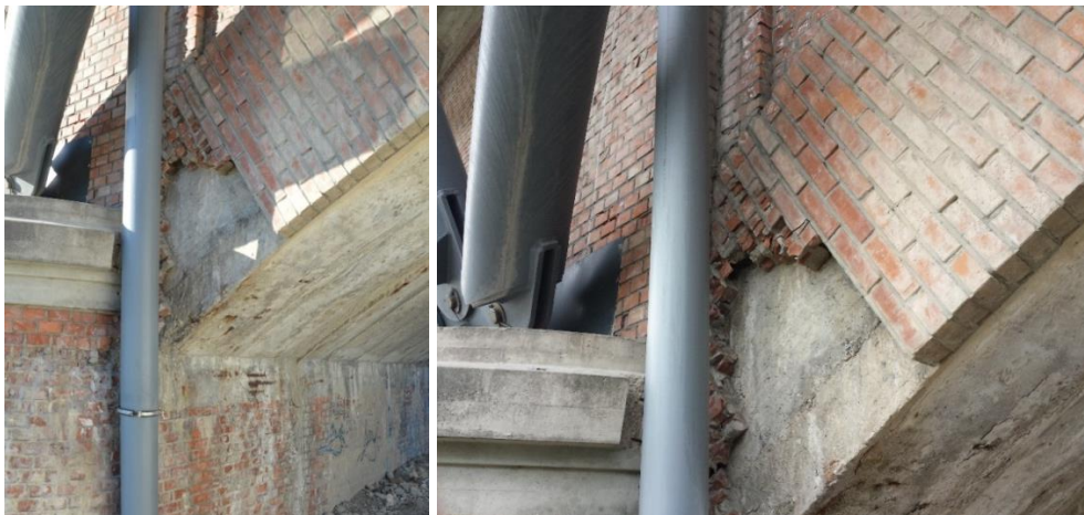
Figura 241 Armilla danneggiata: imposta lato monte arcata N°20. Evidenza di assenza di collegamento fra arco e muratura.
