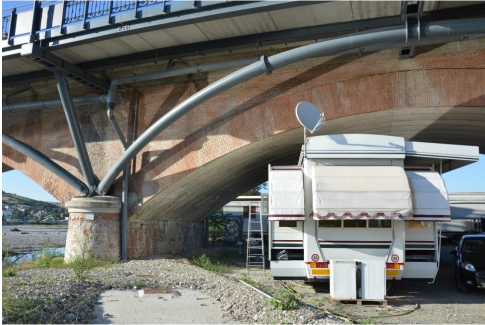
Figura 240 Zona altamente pericolosa e di facile accesso al di sotto dell'armilla danneggiata.
