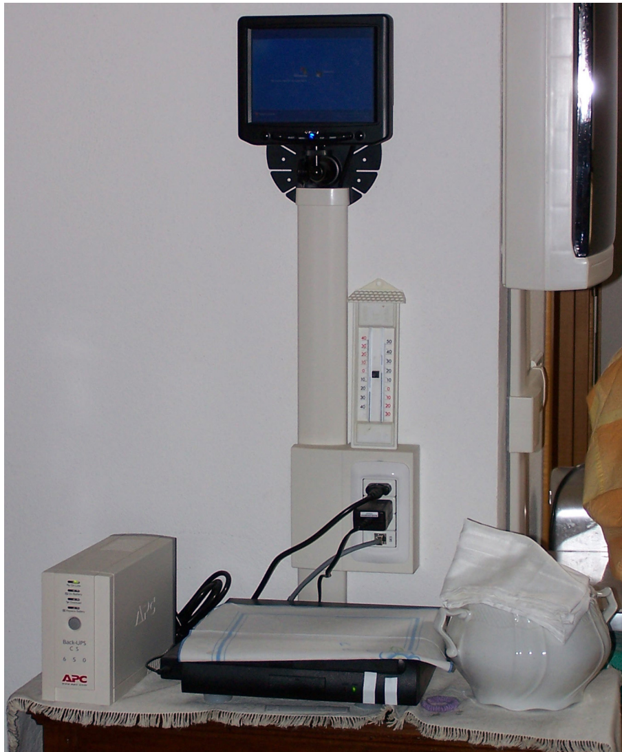
Figura 8.3: Pannello LCD con touch-screen installato nell'appartamento dei custodi. Si vede in basso anche l'unità PC embedded su un mobile.
