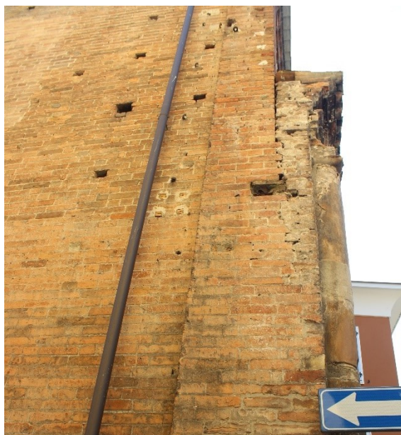
Fig. 229 – Piacenza, chiesa di Sant'Ilario – angolo sud-ovest, dettaglio appoggio struttura in aggetto di facciata
