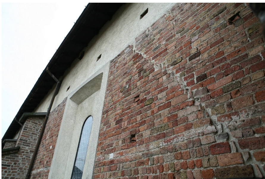
Fig. 53 – Piacenza, chiesa di Sant'Eufemia – cleristorio nord (1^ campata occidentale), particolare muratura e frattura per cedimento facciata
