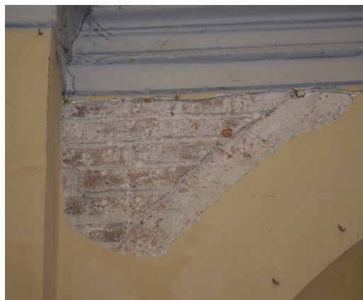
Fig. 179 – Piacenza, ex chiesa di San Matteo – interno, lacerto di muratura arcata longitudinale sud
