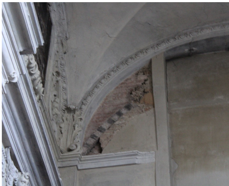
Fig. 211 – Piacenza, chiesa dei Santi Nazario e Celso – controfacciata, settore centrale – resti arcone bicromo
