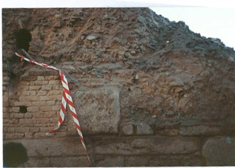
FIG. 23-Foto Chiesa Cattedrale di Pavia dopo il crollo della torre
