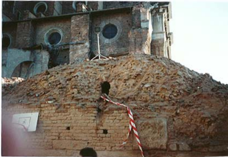
FIG. 21-Foto Chiesa Cattedrale di Pavia dopo il crollo della torre
