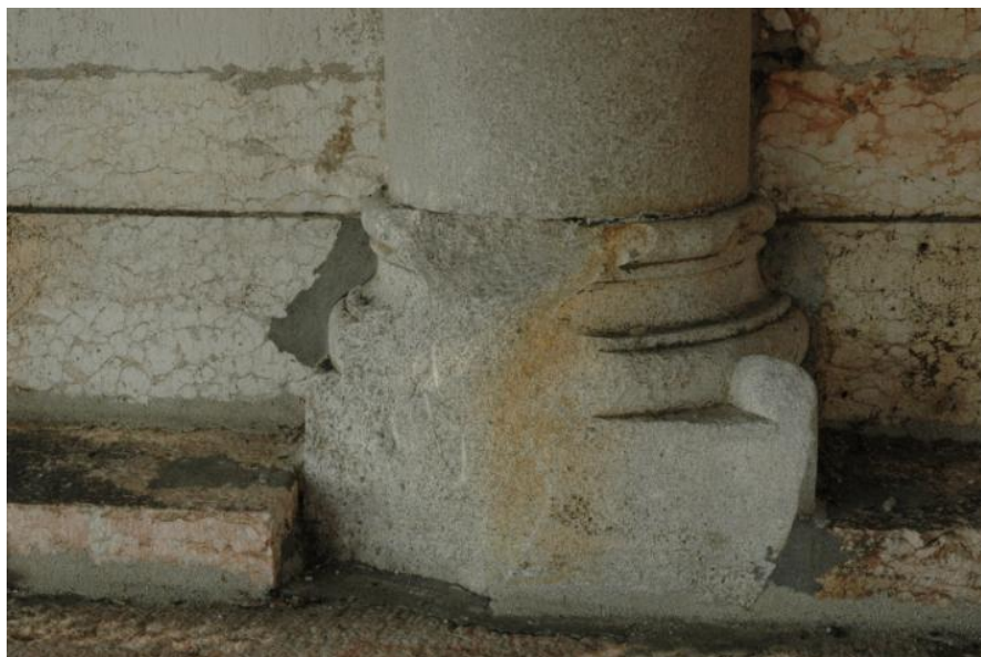
FIG. 54-Distacco alla base di una semicolonna addossata al paramento lapideo.
