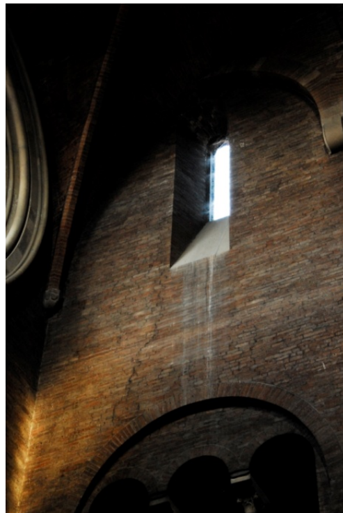
FIG. 33- Lesione visibile lungo il prospetto nord della navata centrale, in prossimità del prospetto principale, dovuta ad meccanismo di ribaltamento del fronte ovest.
