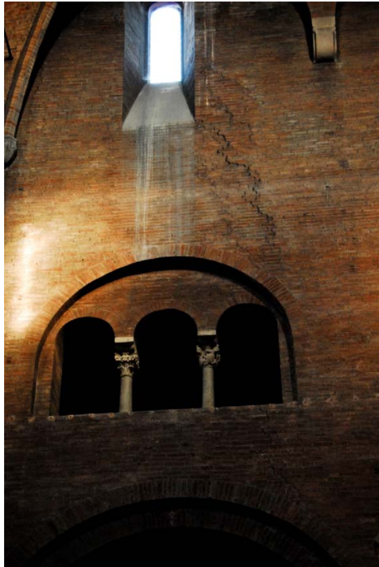
FIG. 39-Lesione visibile lungo il lato nord interno della navata centrale all'altezza della terza campata. Il sistema di lesioni inizia a partire dalla finestra per scendere in corrispondenza del finto matroneo e dell'arco sottostante.
