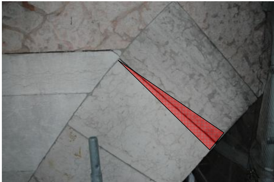
FIG. 8,9 Particolare arco ovest, lesione a in prossimità della chiave dell'arco
