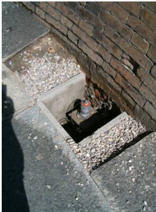
FIG. 92- Estensimetro sistemato in prossimità della Torre
