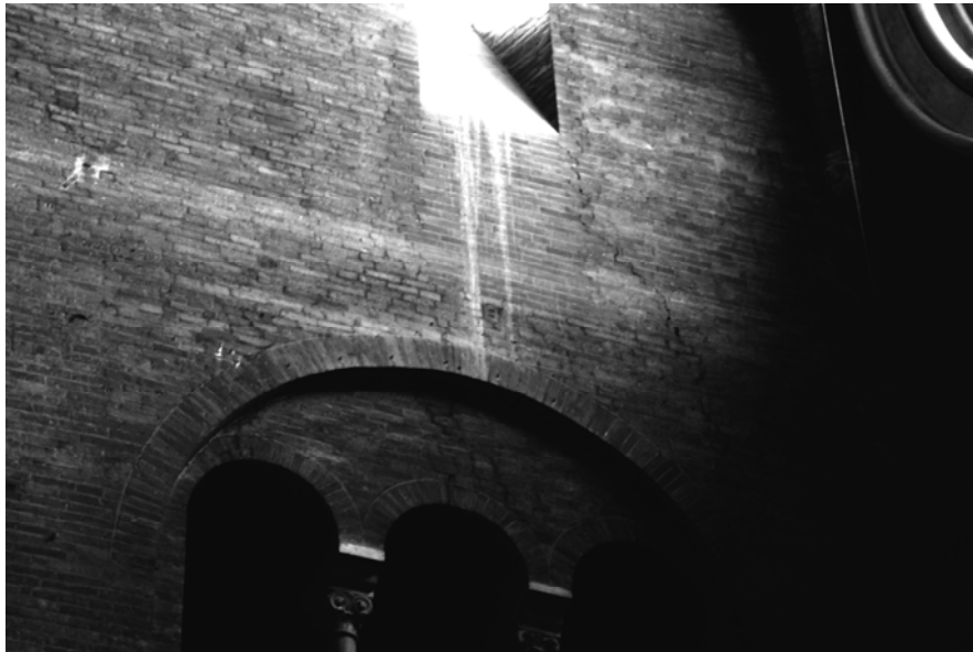
FIG. 32- Lesione visibile lungo il prospetto sud della navata centrale, in prossimità del prospetto principale, dovuta ad meccanismo di ribaltamento del fronte ovest.
