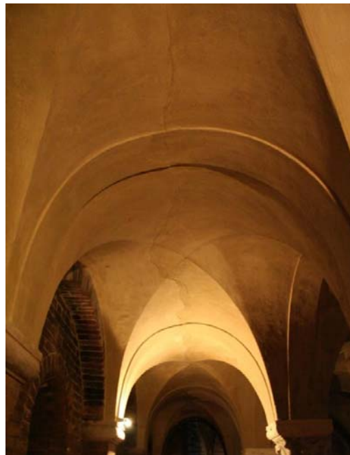
FIG. 28- Lesione visibile lungo il lato settentrionale della cripta. La rottura attraversa tutte le volte a sinistra della chiave a testimonianza di un abbassamento del lato nord.
