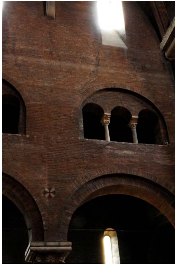
FIG. 38-Lesioni visibili sul lato sud interno della navata centrale (terza campata). Una più alta parte dalla finestra, la seconda più bassa dal finto matroneo. Queste lesioni mostrano un cedimento della zon costituita dalle prime tre camapate.
