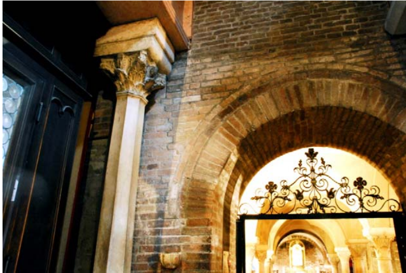
FIG. 43- Lesione visibile dalla navata settentrionale in prossimità dell'ingresso della cripta dovuta d un cedimento del lato nord.
