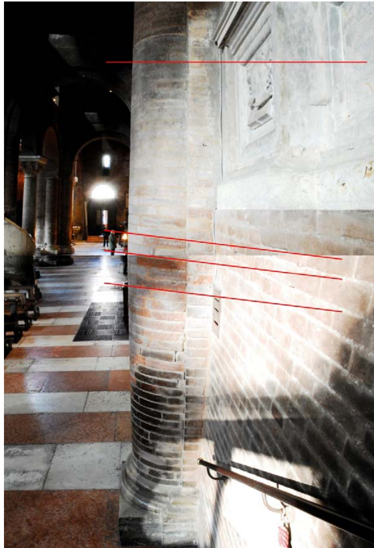
FIG. 30- Immagine di semicolonna in laterizio addossata al prospetto settentrionale interno. La muratura nei primi metri di sviluppo presenta i letti di posa inclinati verso l'esterno, segno di un iniziale cedimento corretto in prossimità del capitello
