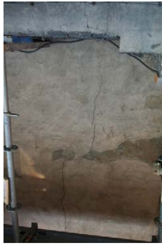
FIG. 36 Immagine della facciata del Duomo , particolare dove si vede la lesione pressoché verticale mediana che attraversa tutta la facciata
