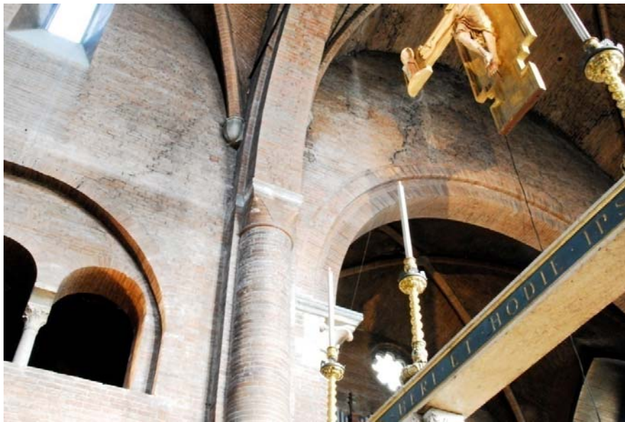
FIG. 31- Lesioni visibili dalla zona presbiterale lato nord, situate negli archi e nella muratura della navata centrale. Le lesioni mostrano un cedimento verso est. Lo stesso sistema di lesioni si trova simmetricamente sul lato sud.
