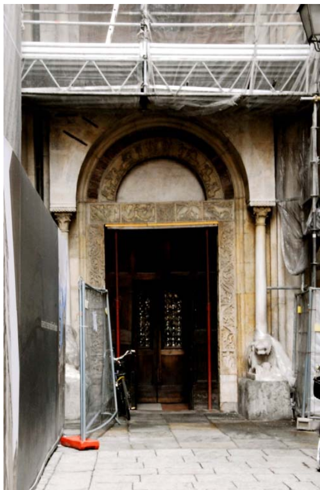
FIG. 44- Immagine che riprende la Porta della Pescheria lungo il lato settentrionale del Duomo. Si nota la netta inclinazione verso est causata dai cedimenti in atto di Torre e Duomo.
