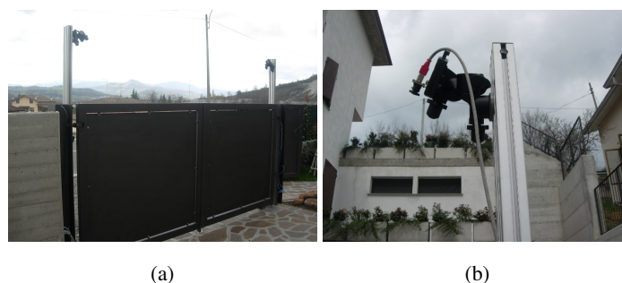
Figura 2.1: Cancelli automatici di test a ed un particolare dell'installazione delle telecamere b .
