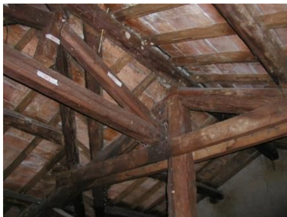
6-23_Elementi lignei di copertura, identificazione degli elementi e delle problematiche riscontrate.
