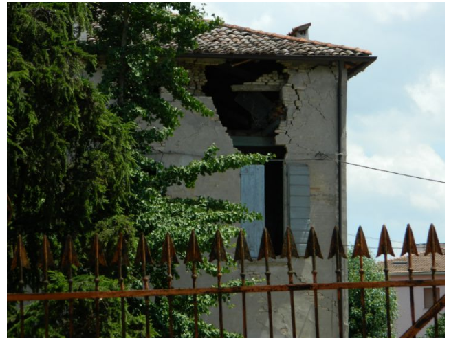
Figura 45_Edificio residenziale Cavezzo, MO, ribaltamento della facciata con cuneo di distacco
