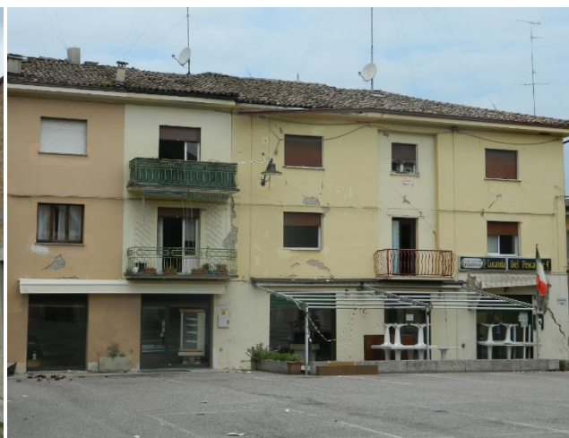
Figura 33_Edificio residenziale, Cavezzo, MO, Flessione verticale fuori dal piano di facciata
