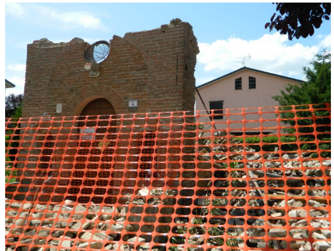
Figura 37_Chiesa di Cavezzo, MO, Ribaltamento timpano fuori dal piano e disgregazione
