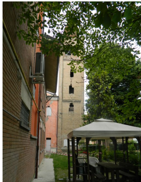
Figura 41_Chiesa di Cavezzo, MO, Lesioni longitudinali sul campanile
