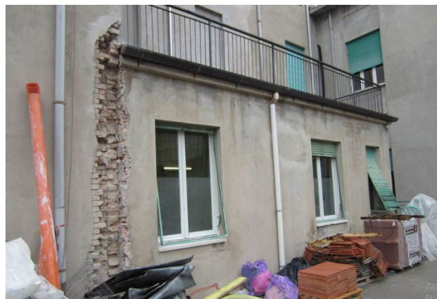
Figura 47_Ospedale di Mirandola, MO, martellamento tra corpi di fabbrica con irregolarità piano altimetriche semplicemente accostati
