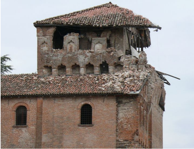
Figura 42_Castello di Finale Emilia, MO, Rotazione della copertura e rottura dei merli
