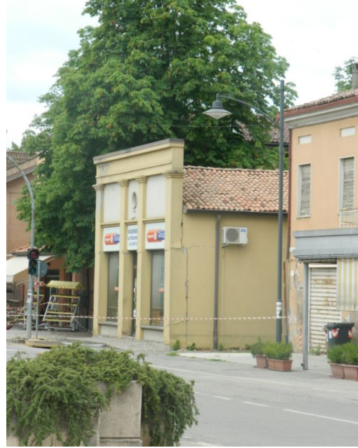
Figura 35_Edificio commerciale, Cavezzo, MO, Ribaltamento fuori dal piano di facciata
