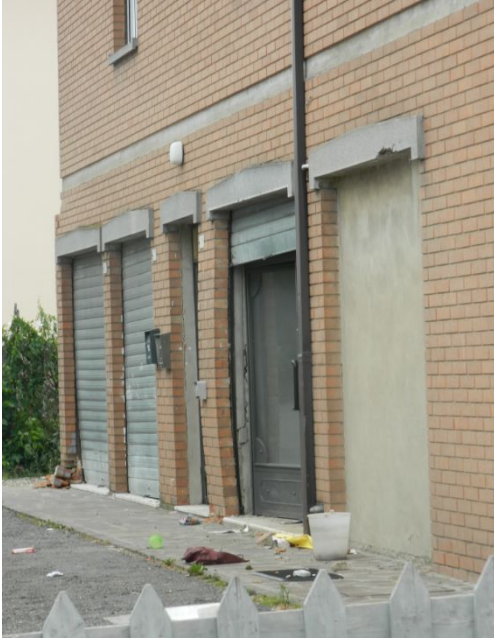
Figura 34_Edificio commerciale, Cavezzo, MO, Flessione verticale fuori dal piano di facciata
