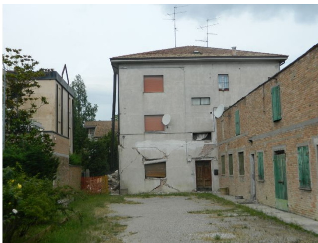
Figura 32_Edificio residenziale, Cavezzo, MO, Flessione verticale fuori dal piano di facciata
