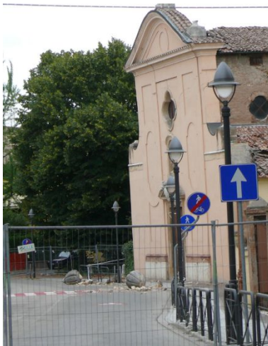
Figura 36_Chiesa di Cavezzo, MO, Ribaltamento semplice della facciata
