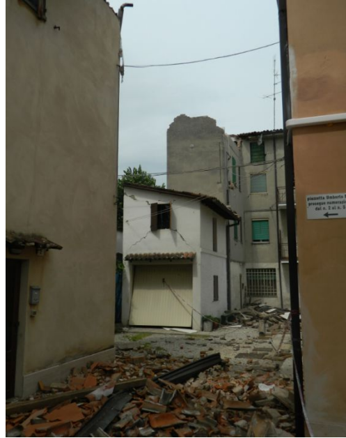
Figura 49_Edificio residenziale Cavezzo, MO, lesioni diagonali a taglio
