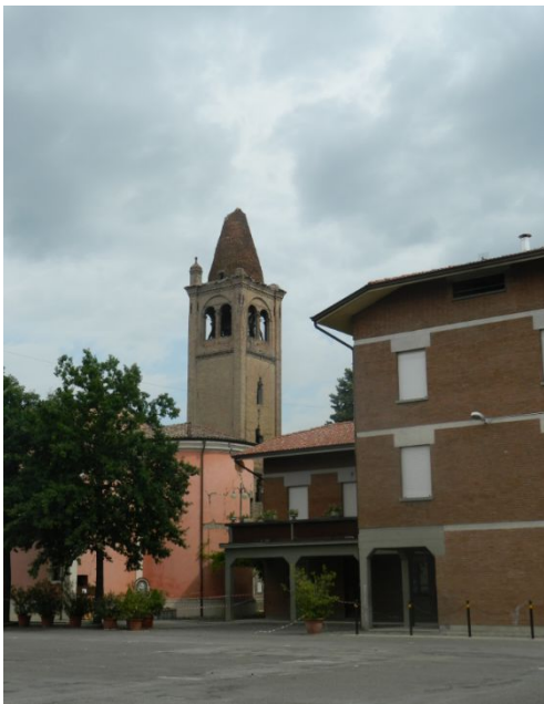
Figura 40_Chiesa di Cavezzo, MO, Lesioni longitudinali sul campanile e dell'abside
