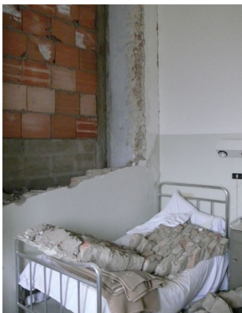
Figura 30_Ospedale di Finale Emilia, MO, Ribaltamento semplice di paramento murario
