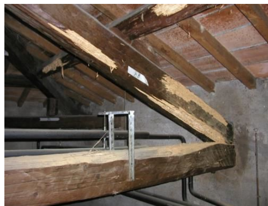
6-25_Elementi lignei di copertura, identificazione delle problematiche riscontrate.
