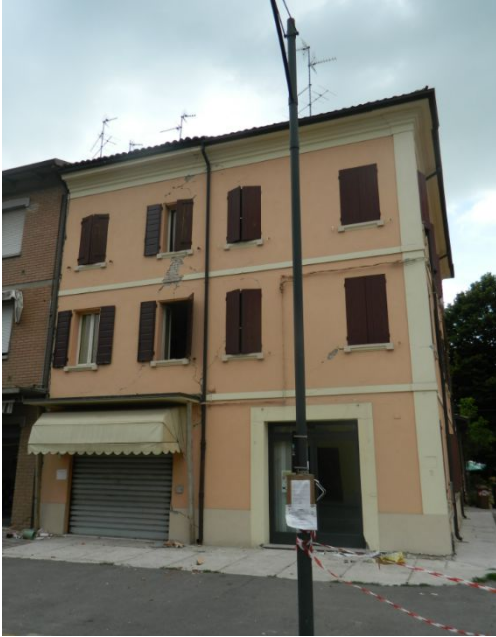
Figura 48_Edificio residenziale Cavezzo, MO, lesioni diagonali a taglio
