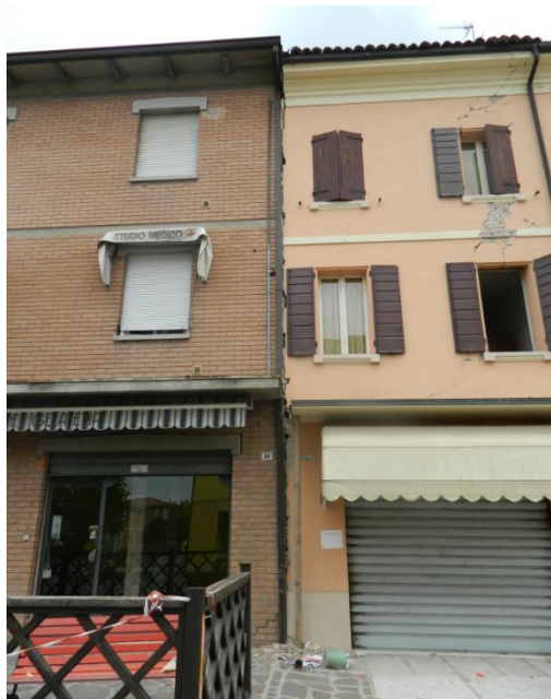
Figura 46_Agglomerato edilizio, Cavezzo, MO, martellamento tra corpi di fabbrica semplicemente accostati
