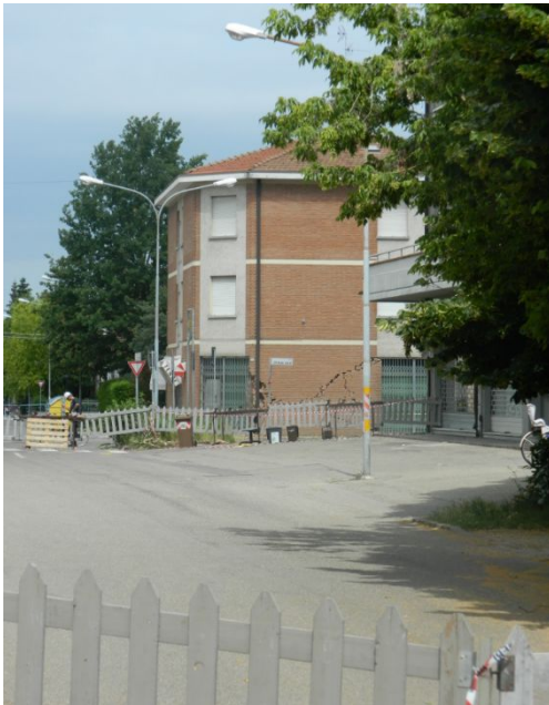
Figura 44_Edificio residenziale Cavezzo, MO, ribaltamento della facciata con cuneo di distacco
