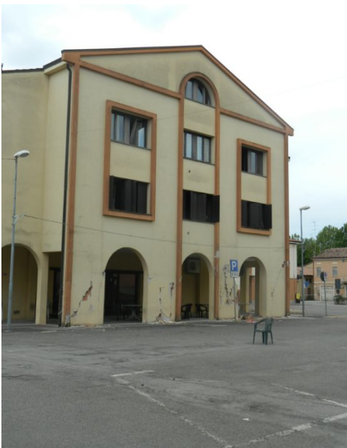
Figura 50_Edificio commerciale Cavezzo, MO, lesioni diagonali a taglio
