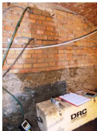
Figura 13_Campagna di indagini con martinetti doppi svolte presso il Padiglione Morselli, Reggio Emilia
