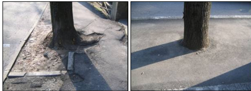
Figura 5.5 – via Abbeveratoia: il cordolo di contenimento cade all'interno del sesto di impianto (sinistra) e la pavimentazione arriva fino al colletto della pianta (destra)
