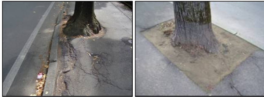
Figura 5.4 – viale dei Mille: sesto di impianto non definito con gravi dissesti nella pavimentazione adiacente (sinistra) e via Capelluti: sesto di impianto di dimensioni limitate con prime fessure nella pavimentazione adiacente (destra)
