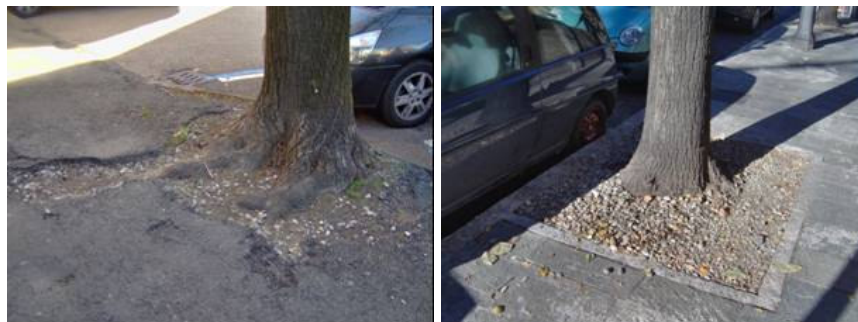
Figura 5.9 – via Costituente: pavimentazione in conglomerato bituminoso gravemente dissestata (sinistra) e via Cocconcelli: pavimentazione in lastricato (destra)
